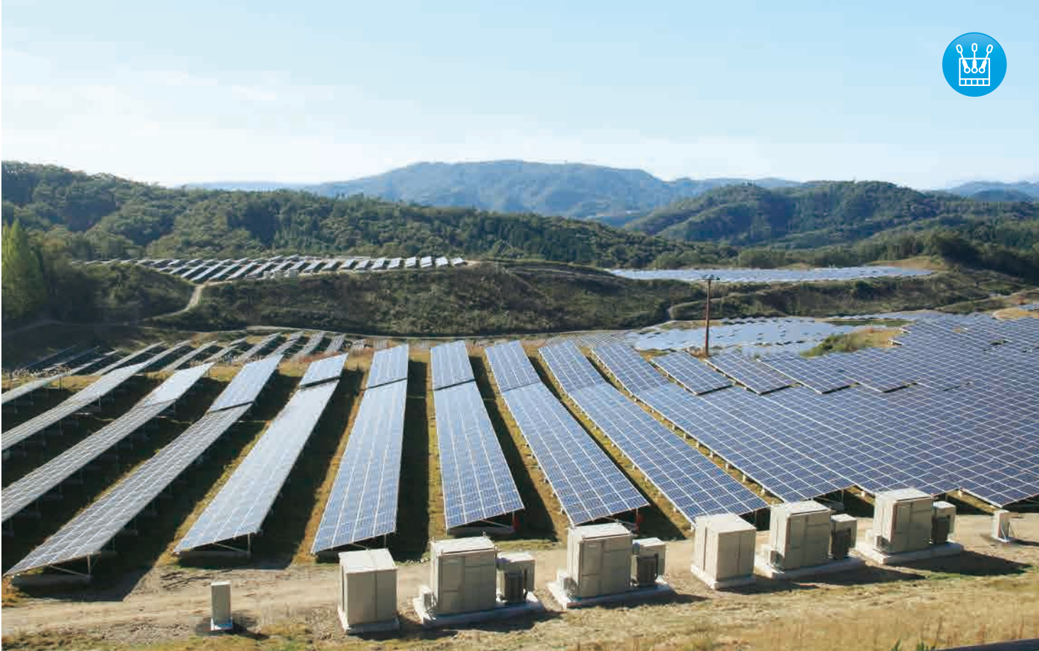
ひまわりソーラー発電所8号 全景
