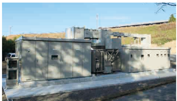
33kV特高連系設備
