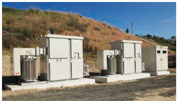
500kWパワーコンディショナ (SOLARPACK 500)
